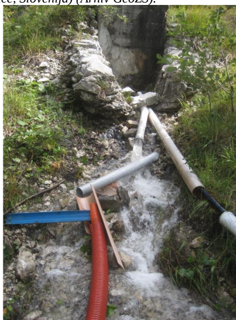
Slika 4. Primer neustrezne izvedbe in vzdrževanja drenažnega sistema, zaradi katerega površinska voda nekontrolirano teče po plazu in čez cesto (izvir Urbas, plaz Urbas, Jesenice).
